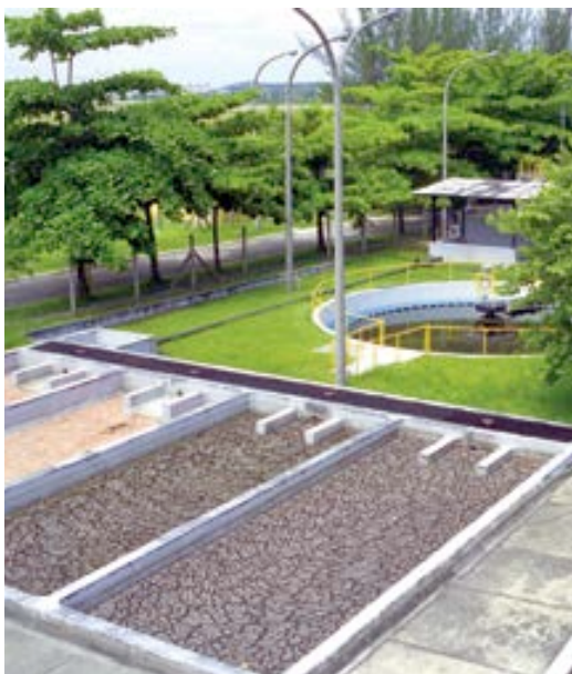
Secagem de lodo da estação de tratamento de esgotos no Galeão
